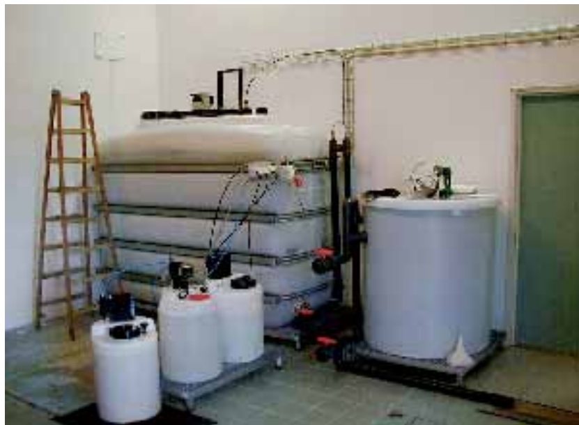
Behandlingsanlægget til rensning af kondensat på Ringkøbing Fjernvarmeværk.
