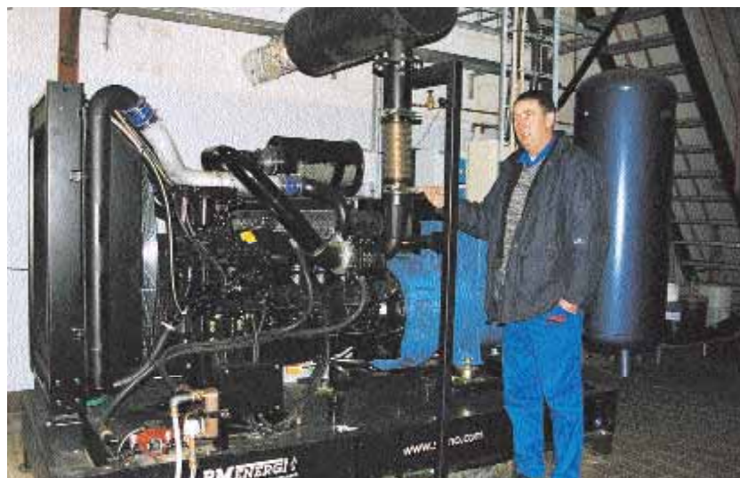
Hals Fjernvarme har investeret 300.000 kr. i et nødstrømsanlæg.
