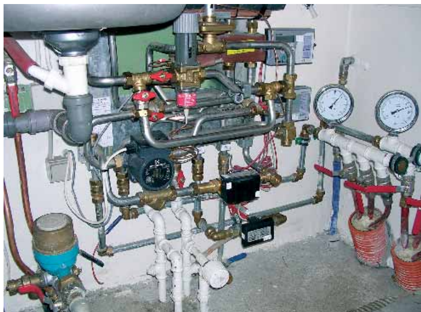
Fjernvarmeinstallationen hvor de seks stikledninger kan aflukkes hver for sig.
