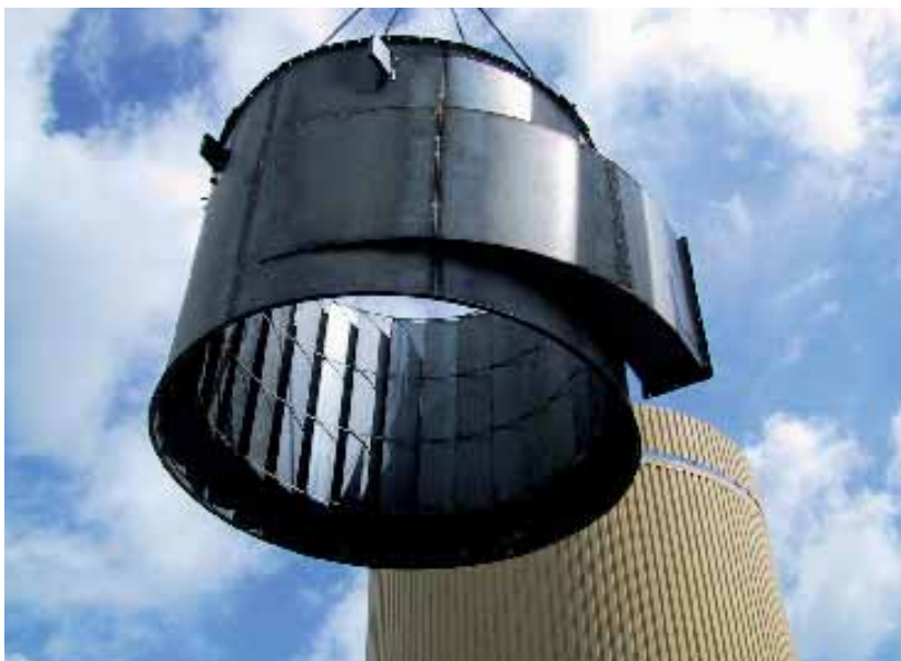
Filterets effektive, indvendige konstruktion ses tydeligt her, hvor det hejses på plads. Filteroverfalden er hele 612 m 2 når filtret er helt på plads og i funktion.
