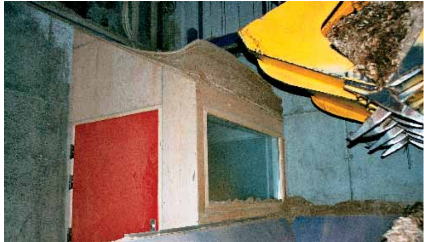
En sluse er meget effektiv til at forhindre sporerne fra lageret i at sprede sig til kedelhallen. Slusen kan bygges enten på lagersiden eller halsiden af den oprindelige branddør.
