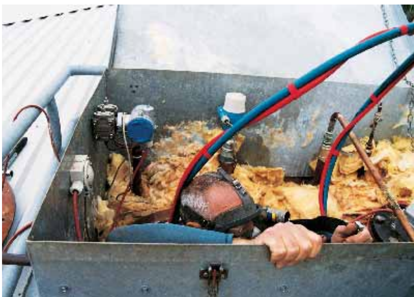
Først går turen de 10 meter op på ydersiden af tanken, inden Jørgen Høgberg kravler ned i akkumuleringstanken, hvor vandet er kølet ned til 36-39 grader. På dykkermasken er monteret lys og videokamera, som hjælper ham med at tjekke tanken for skader.
