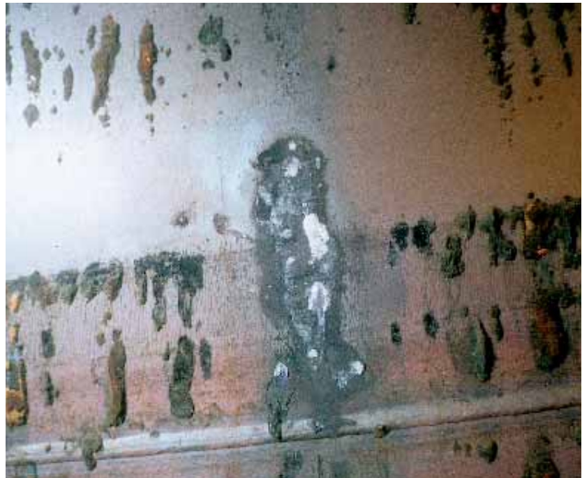
Sigtbarheden ved inspektionen i Nørre Aaby var for ringe til at tage gode billeder af tanken, der ellers var i fin stand. Værre ser det ud i denne tank, hvor skaderne er tydelige. De blanke kratre er tegn på, at tæringen fortsat udvikler sig. Foto: JH-Dyk.
