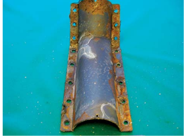
Foto 6: Afgreningsmuffe med begyndende overflade rust.
