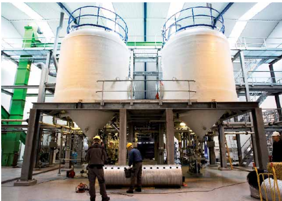
Kommunekemi har udviklet og opført en fabrik, der kan udvinde gødnings-salte af halmflyveaske. Udviklingsarbejdet er sket i dialog med Energi E2 og Dan Gødning, der aftager gødningsproduktet. Foto: Alex Tran.
