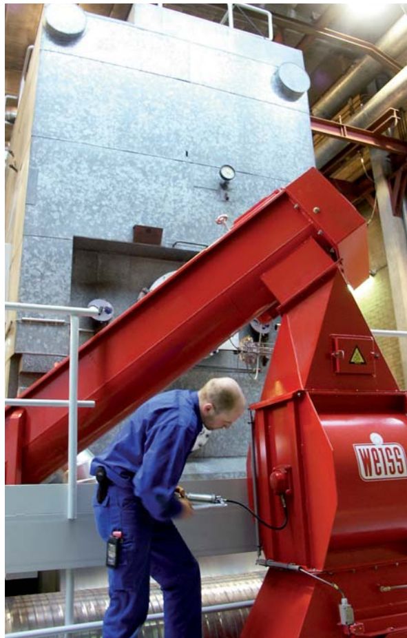
Den gamle fluid-bed kulkedel hos Skanderborg Fjernvarme har fået nyt liv som biomassekedel. Hele den underste del af kedlen er ny, ligesom den orangefarvede indmader. Hele den øverste del af kedlen er genbrugt fra den gamle kulkedel. Foto: Flemming Rasmussen.
