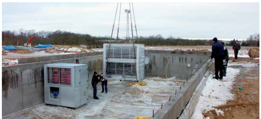
Det nye Fjernvarmens Hus bliver kølet ved hjælp af fjernkøling. Gæsterne ved indvielsen af huset vil dermed kunne studere anlægget, der er det første af sin art i landet.
