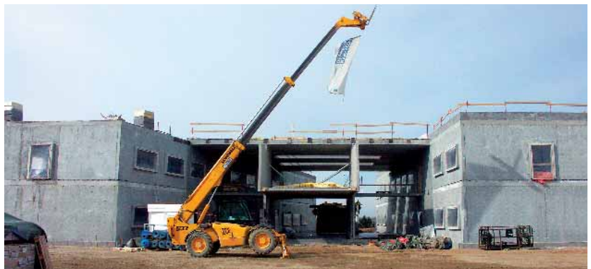
24. marts 2006. En lang vinter gav frostgrader langt ind i marts måned, og murerne kom derfor sent igang med ydermurene. Men det hele blev indhentet og byggeriet blev færdigt til tiden.
