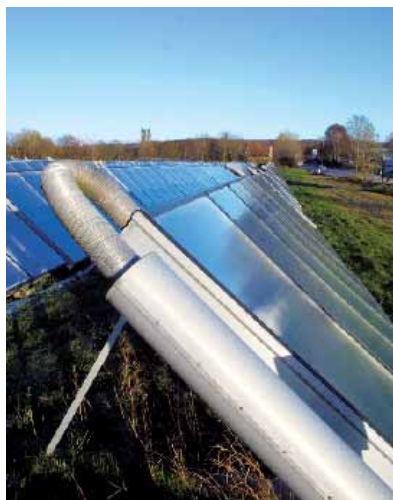
Solvarmeanlæg udnyttes fint af fjernvarme - et eksempel på, at alternative energiformer og fjernvarme hænger godt sammen. Foto: Arcon Solvarme.
