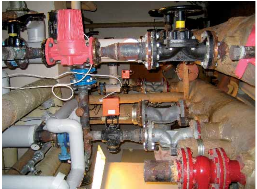
Et teknikrum som det typisk ser ud før renovering.
