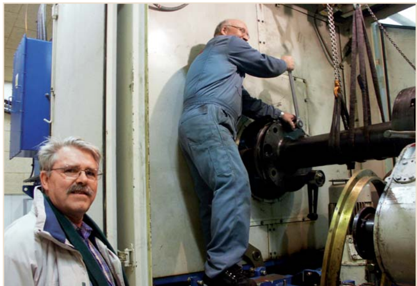
Skjern Fjernvarme har overtaget det vel nok mest komplicerede af Elsams decentrale kraftvarmeværker, et combined-cycle naturgasfyret turbineanlæg. Driftsleder Peter Grønvold tilser her anlægget i forbindelse med en reparation. Foto: Flemming Rasmussen.
