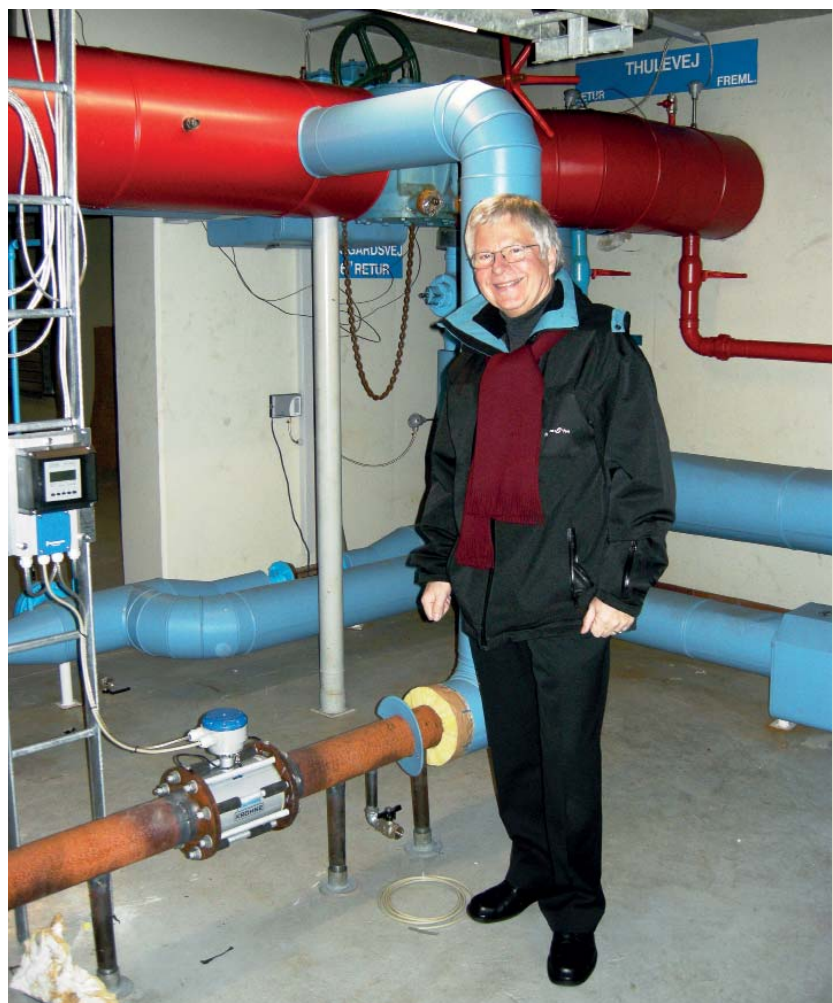
Ebbe Jørgensen, ansvarlig for projektering hos Fjernvarme Fyn, står ved shunten på Korup centralen hvor det varme vand fra transmissionsledningen blandes med koldt returvand.
