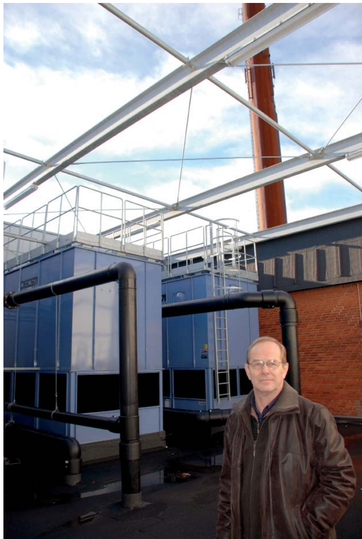
På taget af den bygning, som rummer Hjørring Varmeforsynings nye fjernkølingsanlæg, står tre køletårne. - Af hensyn til omgivelserne har vi skærmet siderne af, så bygningen fremstår pæn, siger direktør Per Karlsson. Foto: Flemming L. Rasmussen.
