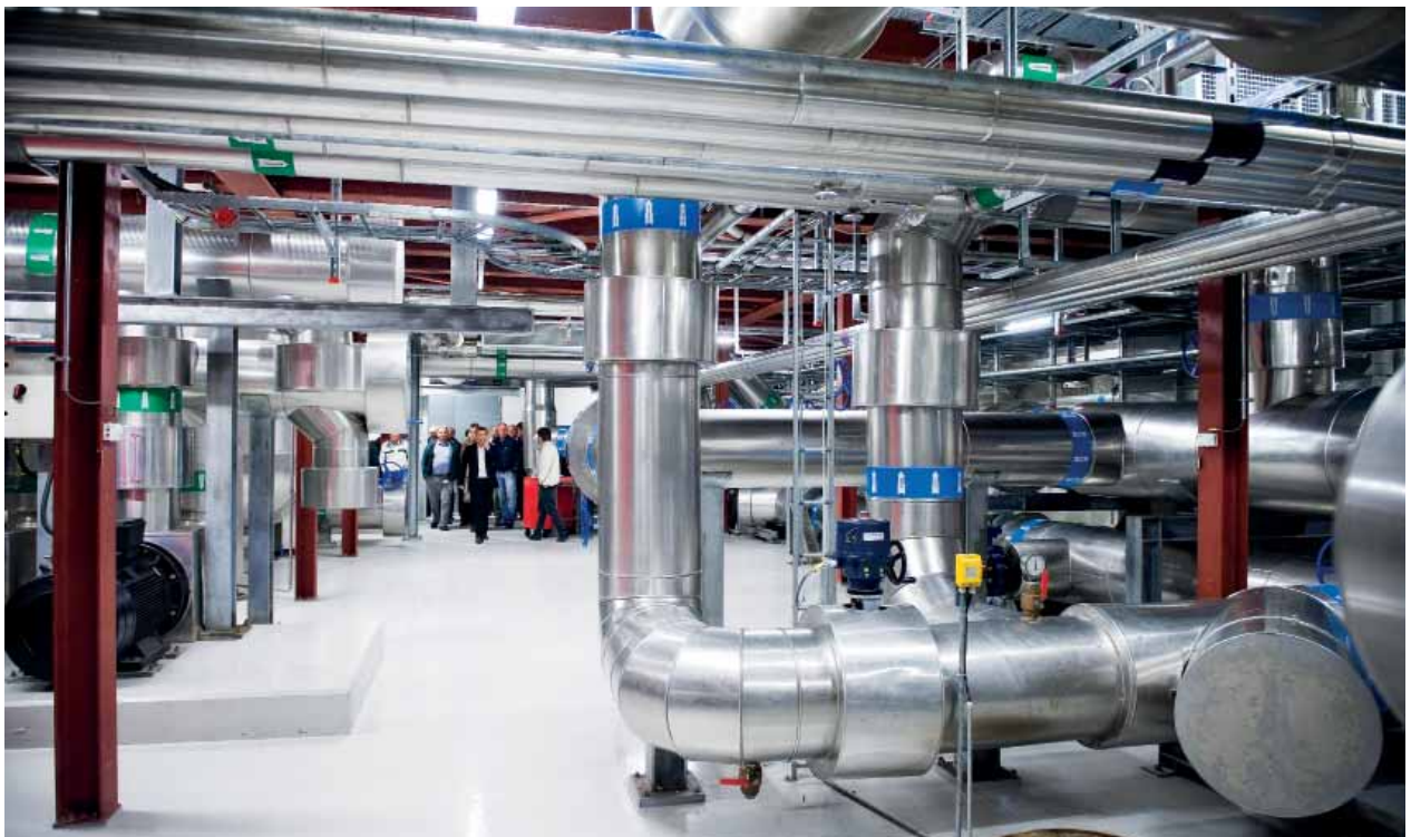
Fjernkølecentralen i Borgergade i København forsyner en række store virksomheder i området ved Kongens Nytorv med fjernkøling. Fjernkølingen erstatter virksomhedernes eldrevne køleanlæg, og reducerer således elforbruget til køling med op til 80 procent og CO 2 -udslippet med op til 70 procent. Foto: Carsten Andersen.
