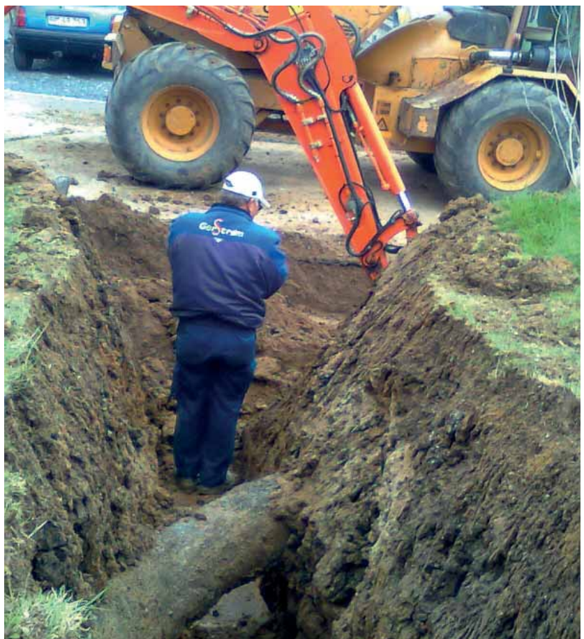
En skorpe af tilfrosset jord havde gennem tre år dannet sig rundt om jordslangen fra husets varmepumpeanlæg. Foto: Rønde Fjernvarme.
