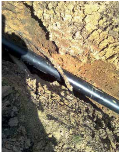
Efter at have fået lov at tømpe i fire dage viste jordslangens rigtige udseende sig inde bag den tilfrosne jord. Foto: Rønde Fjernvarme.
