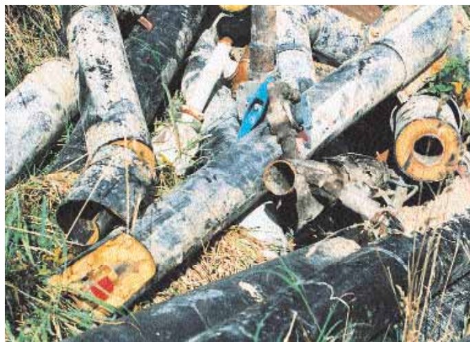
Alderen på præør afgør ofte, hvornår de skal udskiftes, men det er ikke nødvendigvis den ældste del af ledningsnettet, der er dårligst. Foto: Arkiv
