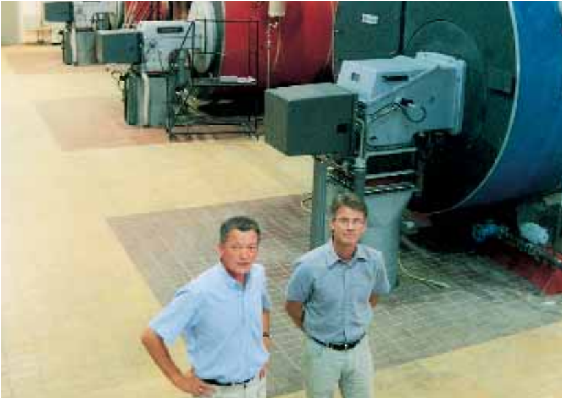
Lars Pilekjær og Jan Strømvig i Odense Universitetshospitals egen kedelcentral. Nu indføres fjernvarme på hele hospitalet og centralen skal så fungere som spidsbelastningscentral.
