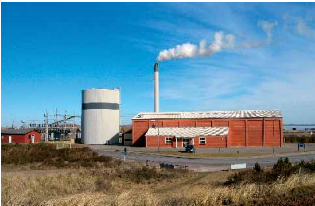
Thyborøn Fjernvarme har med etablering af en akkumuleringsstank og ombygning af kedlen løst problemerne med manglende kapacitet og korrosion i røgrørene. Opgaven er udført i totalentreprise af Tjæreborg Industri. Foto: Erling Jensen.
