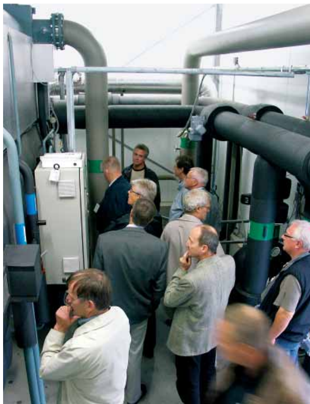
Deltagerne ved Dansk Fjernvarmes seminar om fjernkøling fik blandt andet mulighed for at nærstudere et fjernkølingsanlæg, der leverer køling til forskerparken SCION DTU i Hørsholm. Foto: Flemming Rasmussen.
