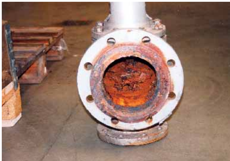
Forekomster af rust og afskalninger kan skabe alvorlige problemer, når sikkerhedsventilen skal udløse og forhåbentlig lukke igen.
