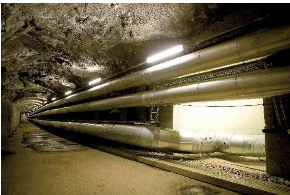
De to øverste rør i tunnelen er fjernvarmen. Det nederste er ventilationen fra anlægget. Luften renses med kulfilter for at undgå naboklager. Foto: Lars Aarø/Fokus.
