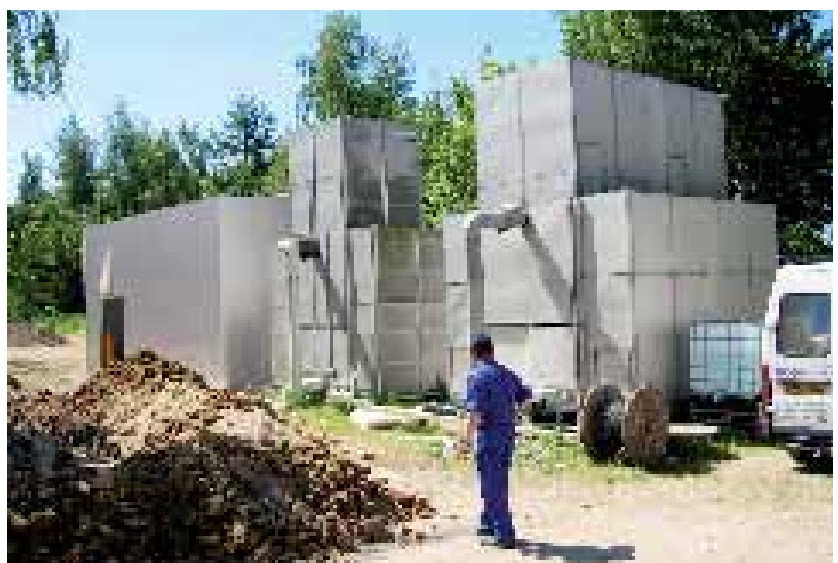
Fjernkølingsanlægget ved Scion DTU i Hørsholm er indtil videre et af de få, der er i drift i herhjemme. Men fjernkøling kan stå foran et gennembrud, i hvert fald er projekter tæt på at blive til virkelighed i både Hjørring og Aabenraa.
