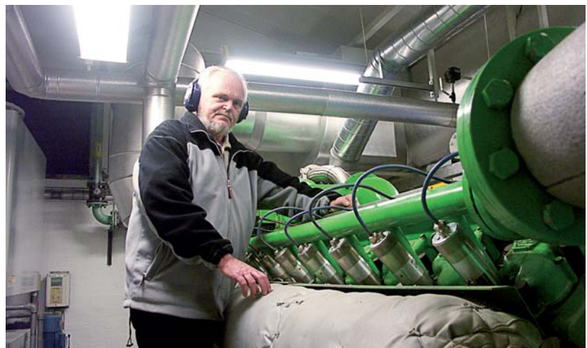
Astrup Kraftvarmeværks formand, Poul E. Andersen, har været igennem en retssag mod en forbruger og et par mindre brande på værket. For ikke igen at stå alene med problemerne har han og bestyrelsen meldt værket ind i Dansk Fjernvarme. Foto: Flemming Rasmussen.
