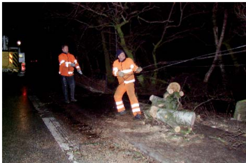
Den voldsomme orkan den 3. december 1999 satte det danske beredskab på en alvorlig prøve. Det gjaldt også i både el- og fjernvarmesektoren, hvor overrevne elkabler medførte strømudfald, hvilket gav en række problemer. Foto: Claus Hansen/Polfoto.
