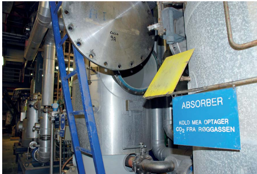
Selvom absorberen og resten af CASTOR-anlægget kun renses 0,5 % af Esbjergværkets røggas, er det Europas hidtil største CO 2 -fangstanlæg. Foto: Flemming L. Rasmussen.
