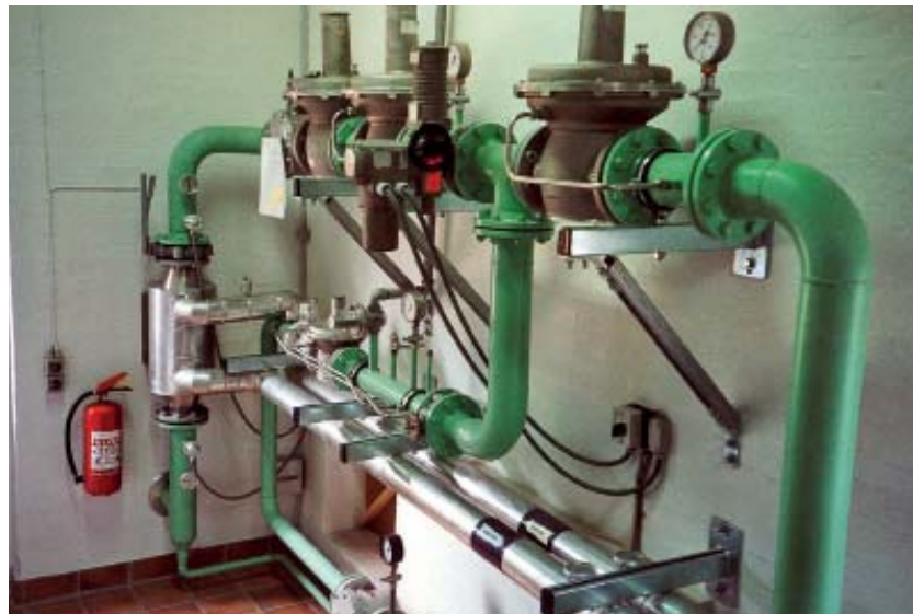
Gasrampe med forsyning og mulighed for mix af bio- og naturgas. På biogasstrengen ses bagerst en varmeveksler, hvor gassen opvarmes for dermed at sænke den relative fugtighed.
