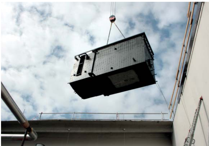
Den nye flis kedel, der her ankommer til Græsted Fjernvarme, imødekommer behovet for at forsyne endnu flere huse med fjernvarme og sikrer også, at oliekedlen ikke skal anvendes så ofte. Foto: Græsted Fjernvarme
