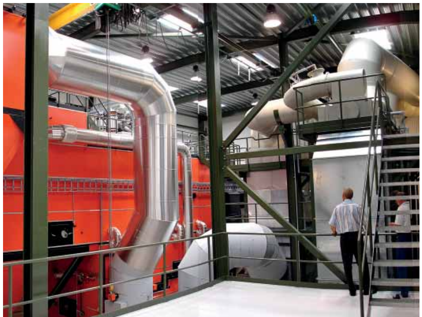
Den første varme, Kibæk Varmeværk sendte ud i 1960, var produceret på olie. Senere blev brændslet kul og fra 1989 flis. I 2006 fik værket installeret en ny fliskedel på 10 MW plus røgrensning og genindvinding på 2,9 MW. Foto: Aaen.
